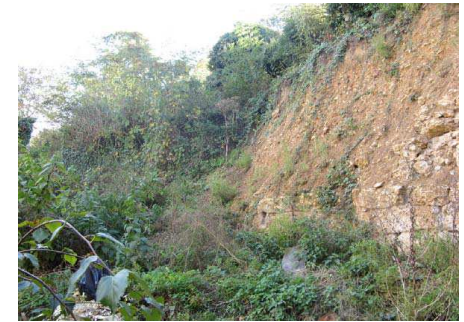
Effondrement d'un mur de soutènement ancien en pierres calcaires à Gray - 2009
