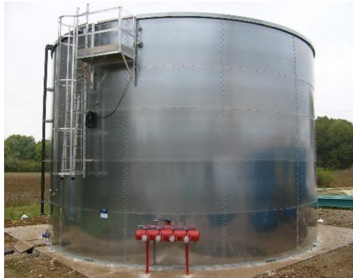
Illustration n°10: réservoir aérien avec dispositif d'aspiration déporté
