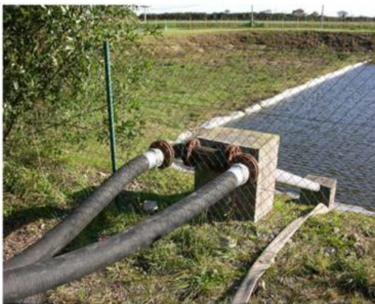
Deux sorties de 100 mm sur une colonne de 150 mm
